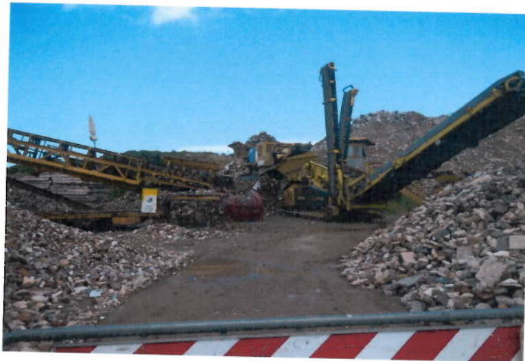
Foto n. 2 – Impianto di vagliatura/frantumazione.
